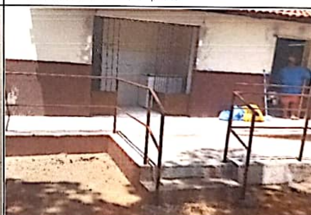
FOTO 06: Degrau de acesso a rampa.
