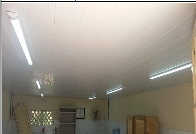
FOTO 11: Luminárias de led nas salas de aula.
