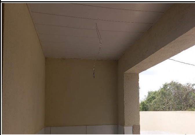
FOTO 08: Forro de pvc na área de circulação dos banheiros.
