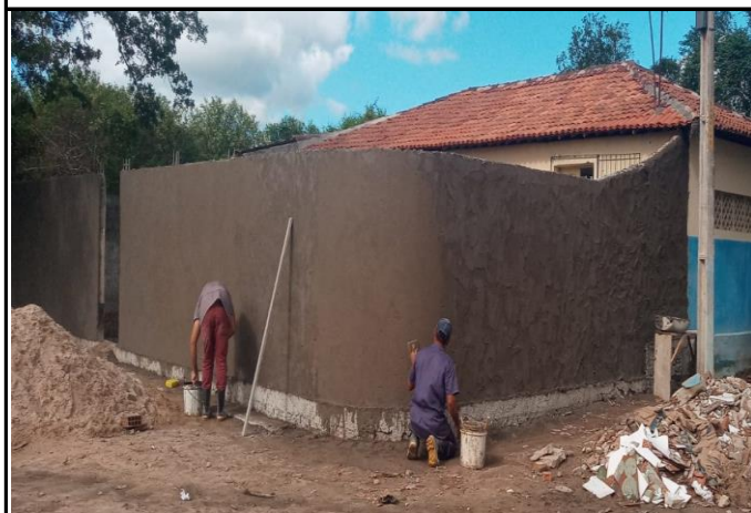
FOTO 03: Massa única no muro frontal da escola.
