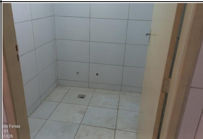
FOTO 06: Revestimento cerâmico no banheiro pne.
