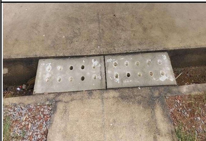
FOTO 09: Grelha de concreto.
