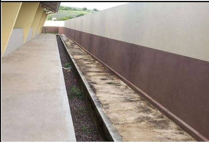
FOTO 08: Canaleta de drenagem.
