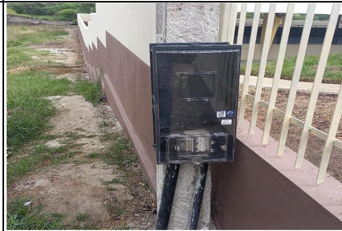
FOTO 10: Entrada de energia da quadra.
