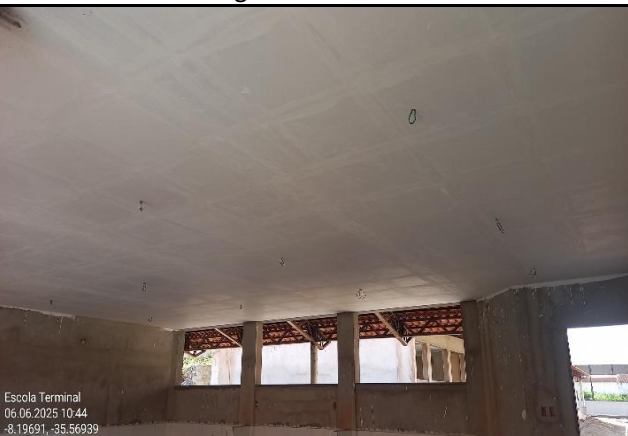
FOTO 16: Forro de gesso do bloco C.
