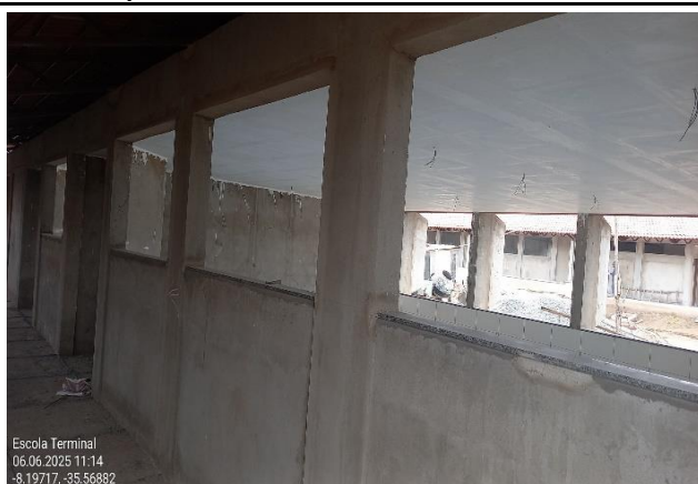
FOTO 14: Peitoril de granito do bloco B.
