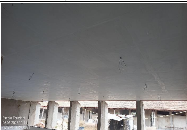
FOTO 18: Forro de gesso do bloco B.
