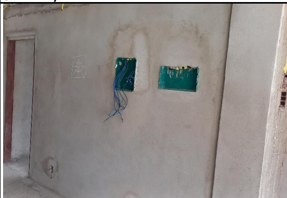
FOTO 02: Eletrica do bloco A.
