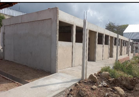
FOTO 04: Reboco externo do bloco E2.
