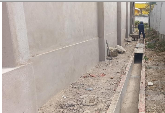
FOTO 08: Reboco do embassamento da quadra no fundo (lado do bloco E1).
